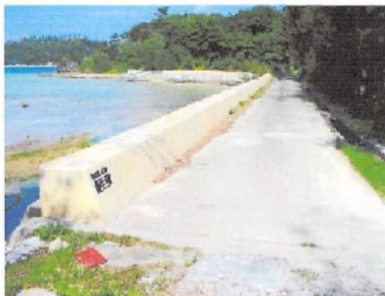
写真-1. 施工箇所全景（平成6年2月） 測定は護岸パレットの両端と中央部の3ヶ所で堤外側、天端部、堤内側の3点計9点で行った。
